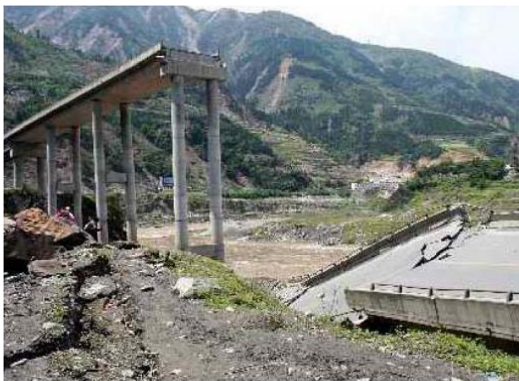
б) повреждение моста, расположенного в горной местности Рисунок 1.7 – Примеры повреждённых мостов на гибких опорах
