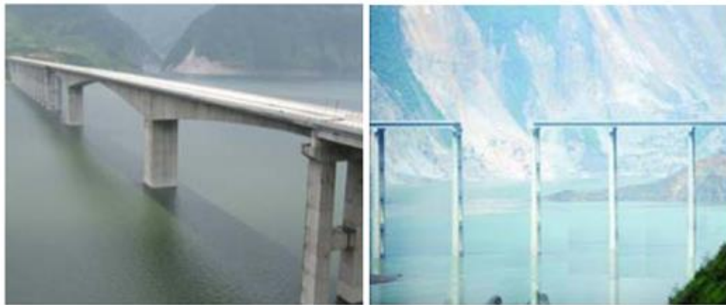
а) повреждённые мосты на гибких опорах
