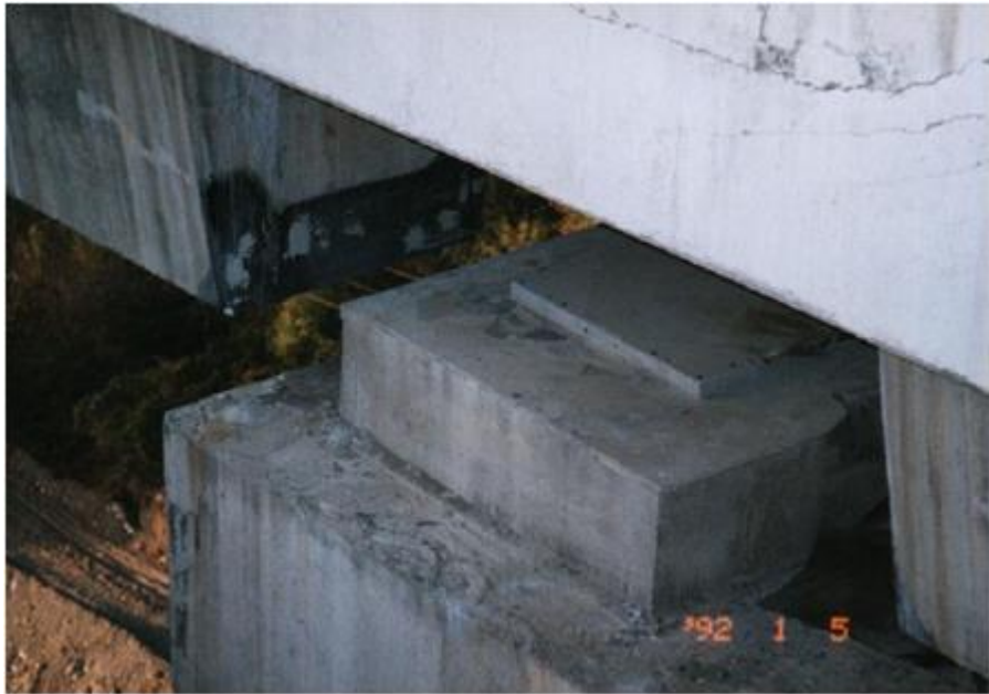
Рисунок 1.6 – Вид фрагмента пролётного строения, смещённого относительно опорной части
