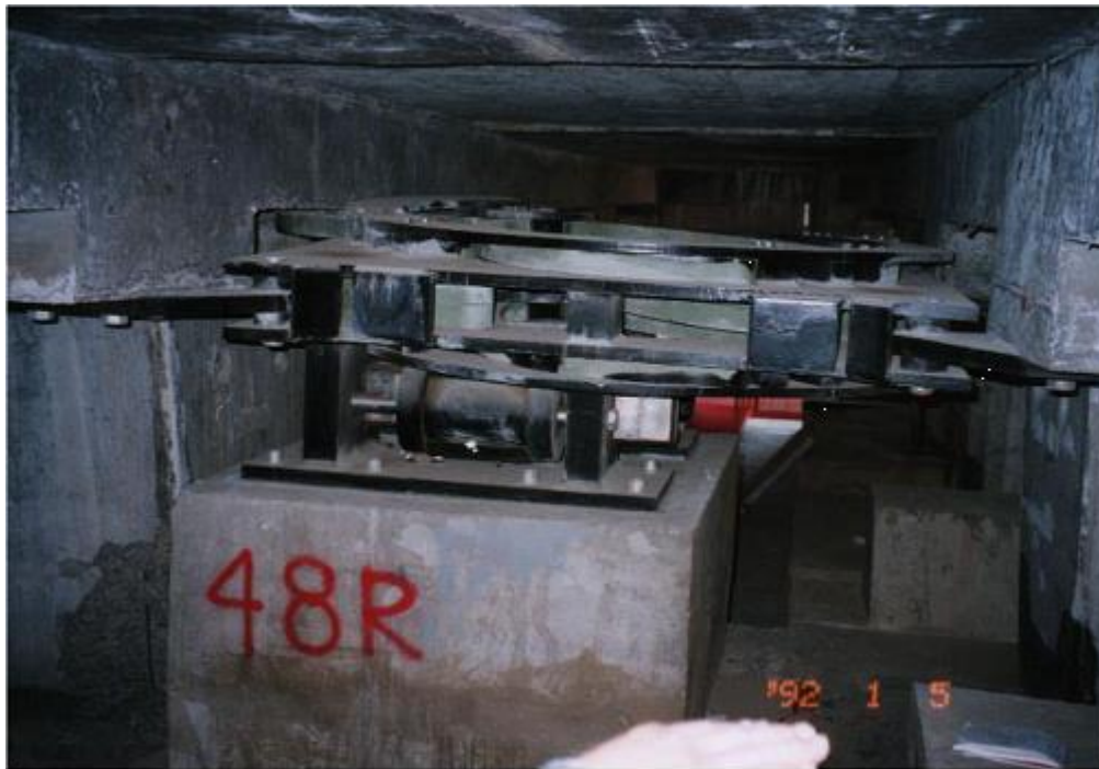
Рисунок 1.5 – Фотография поврежденных демпферов и вязкостных ограничителей
