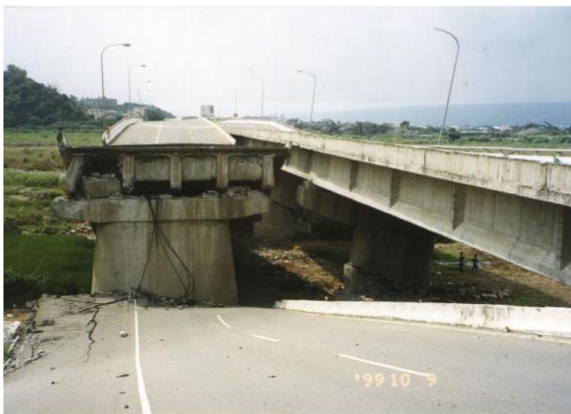
Рисунок 1.3 – Вид разрушенного моста Wu-Shi Bridge при землетрясении Chi Chi (Тайвань)
